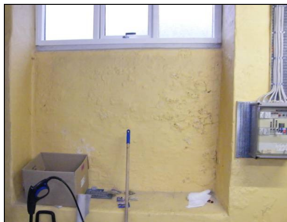
Saltudblomstring på indvendig side af kælderydervæg i varmecentral.
