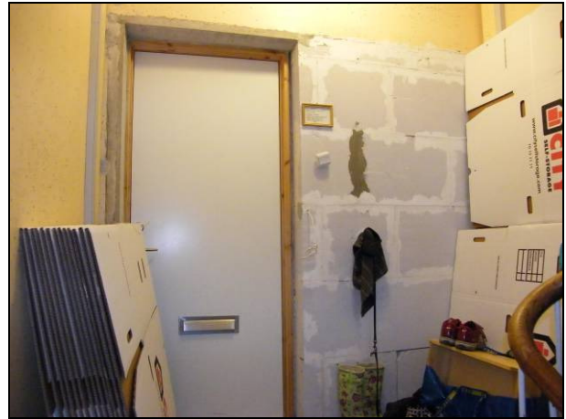
Her et eksempel på en pæn afblænding, dog mangler den endelige overflade samt gerigter omkring dør.
