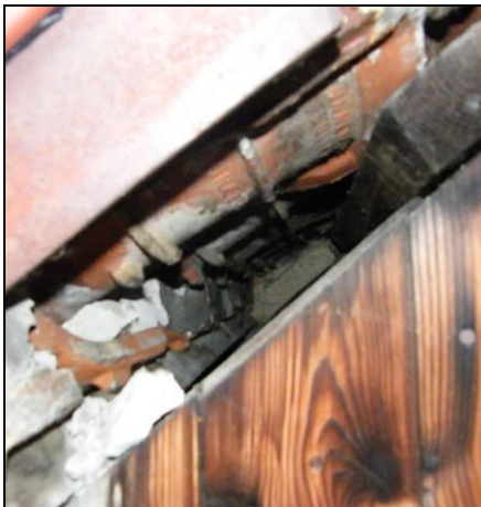
Manglende understrygning af tagsten ved beklædning på indvendig side.
