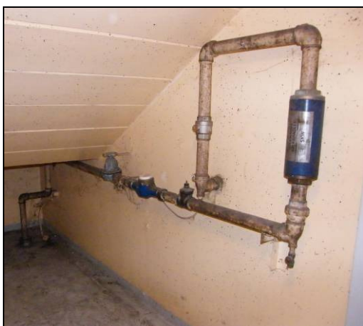
Uisoleret vandrør i trapeopgang.
