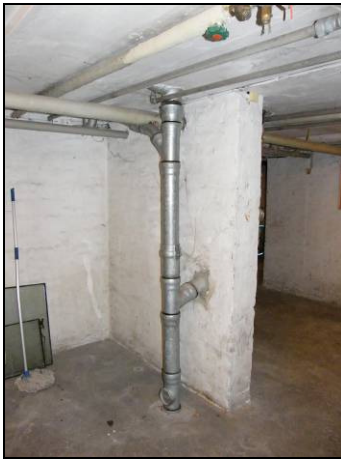
Nyere stående spildevandsledning i kælder.
