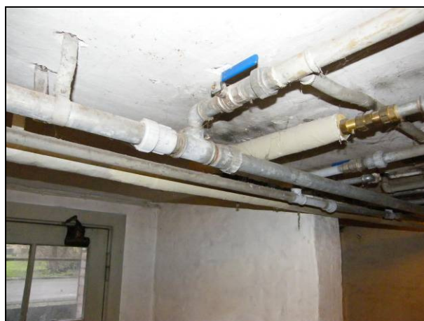
Uisoleret vandrør under loft i kælder.
