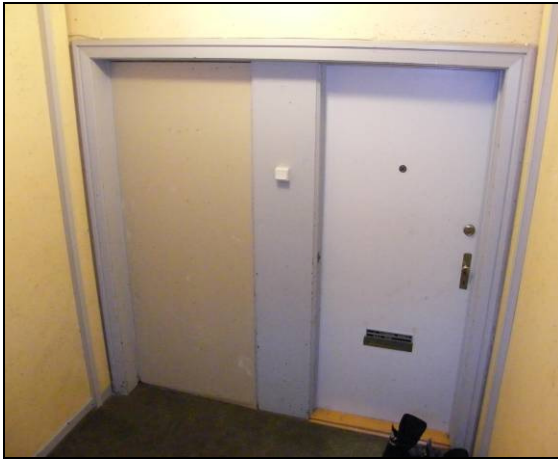
Her en afblænding af hoveddør foretaget uden det store hensyn til udseende.
