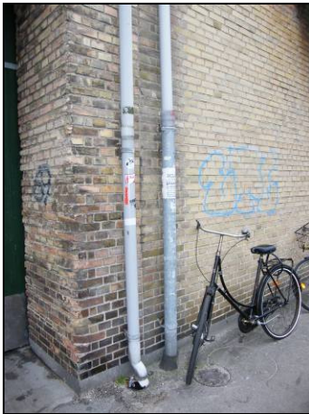
Foreningens nedløb til højre og naboforeningens til venstre. Nedløb ved terræn er udført i varmemeforzinket stålør.
