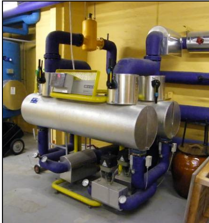
Varmeveksler for fjernvarme.
