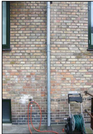
Nedløb i baggård, ved terræn er nedløb også her udført i varmemeforzinket stål.
