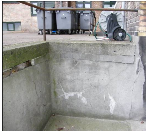
Alvorlige revner og skader på beton omkring kældertrappe.
