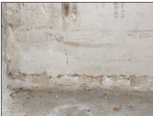
Afskallende puds på 1. skifte mursten.
