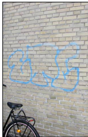
Graffiti på facade mod Stærevej
