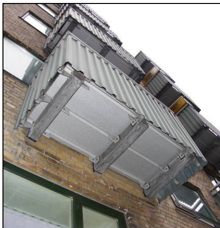
Ingen korrosion i bærende bjælker. Murværk er udskiftet i forbindelse med montering af nye altaner.
