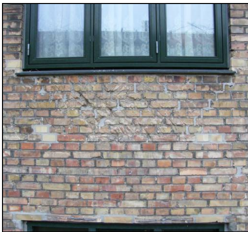
Skader på murværk under sølbænk, facade mod baggård.
